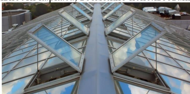
Рисунок 7 - Вентиляционные зенитные фонари
