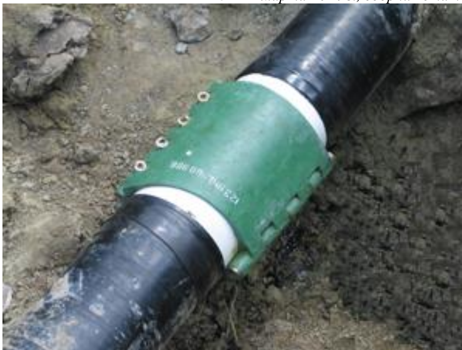
Рис. 3. Участок трубопровода с муфтой УКМТ
